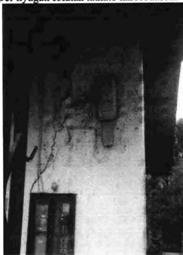
4.) Fotó Az épület Dél-nyugati sarkán lévő repedések.
