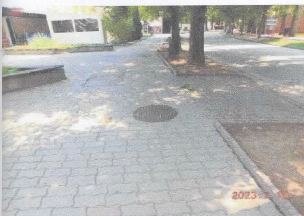
szennyvízcsatorna fedlapja a járdán
